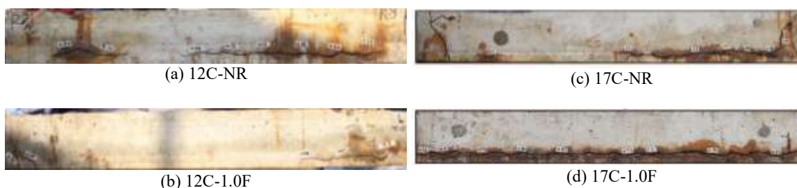
Hình 5: Dầm bị hư hỏng do ăn mòn (chỉ trình bày các dầm điển hình)
