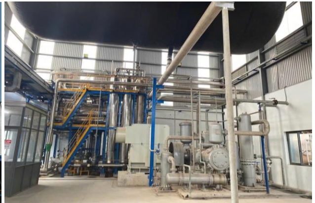
Hình 7. Hệ thống máy nén, xử lý khí CO 2
