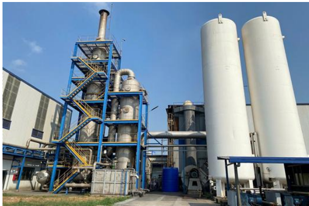
Hình 6. Hệ thống hấp thụ - chứa CO 2 lỏng
