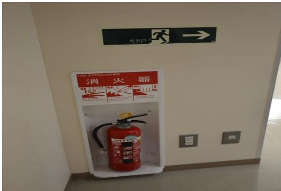
Hình 7: Tủ đựng Bình chữa cháy với bảng hiệu (Nguồn: Ibaraki College, 2017)
