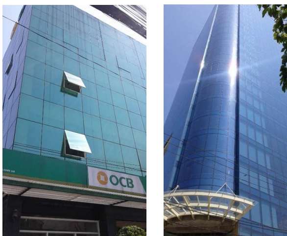
Hình 1. Bề mặt kính hệ mặt dựng không nân nhôm
