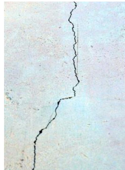
Hình 2: Vết nứt trên bề mặt bê tông tại công trình số 573 Đường Tên Lửa, Bình Tân, TP. HCM
